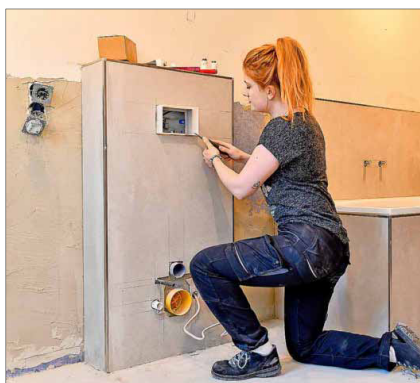
Ihre erste Woche auf der Baustelle war hart. Inzwischen ist die Arbeit für SHK-Anlagenmechanikerin Madita Brauer Routine.
